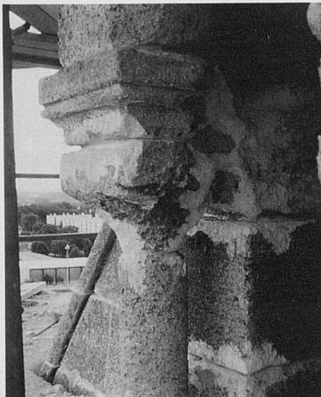
Fig. 11. Altération de la pierre.
