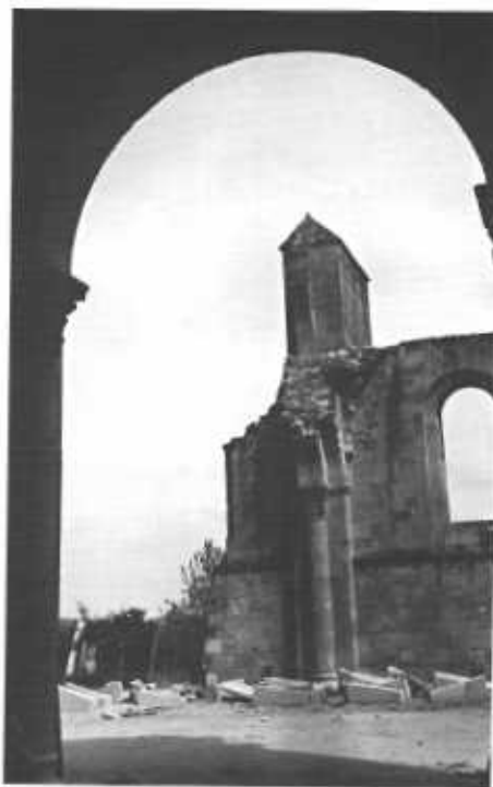
Bas-côté nord avant travaux. Marches de l'escalier de la tour en cours de restauration.
